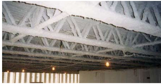
Ein Foto der WTC-Träger mit Brandschutzbeschichtung.
